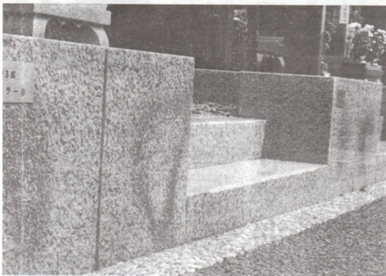
98年増設分の墓で、相次いで確認された御影石の変色＝今年6月、習志野市芝園3丁目の市営海浜霊園
